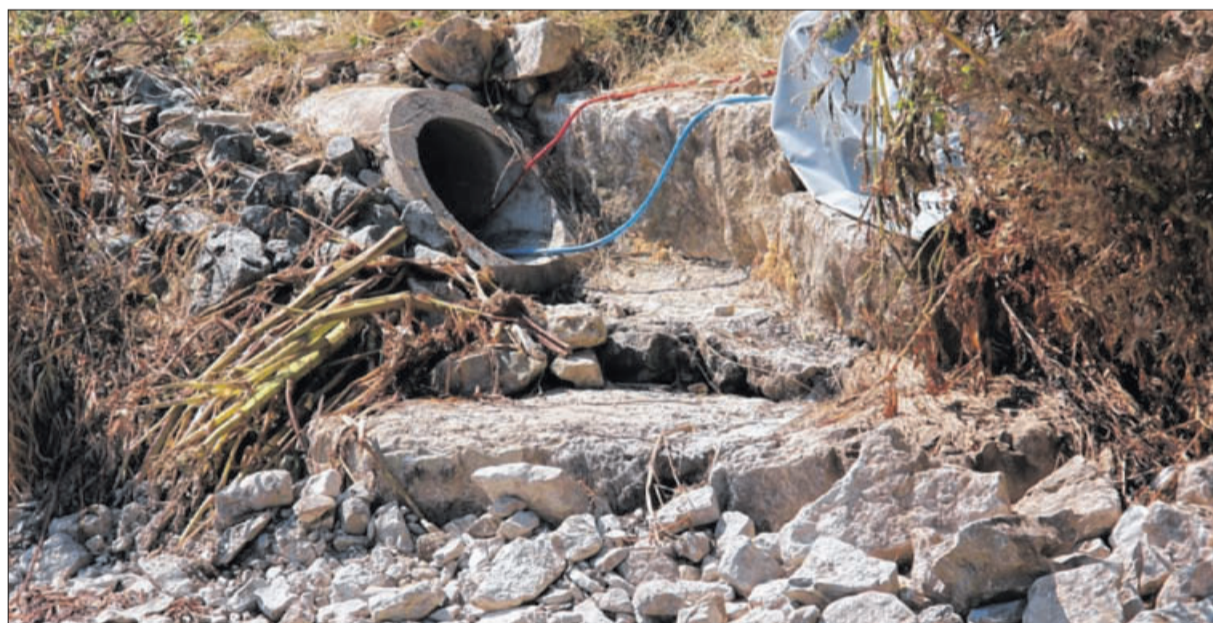
Aus diesem Überlaufkanal gelangte kontaminiertes Löschwasser in den Mühlkanal und von dort in die Jagst. Die Frage ist: Wie lange war dieser offen und warum? Foto: Jens Sitarek
